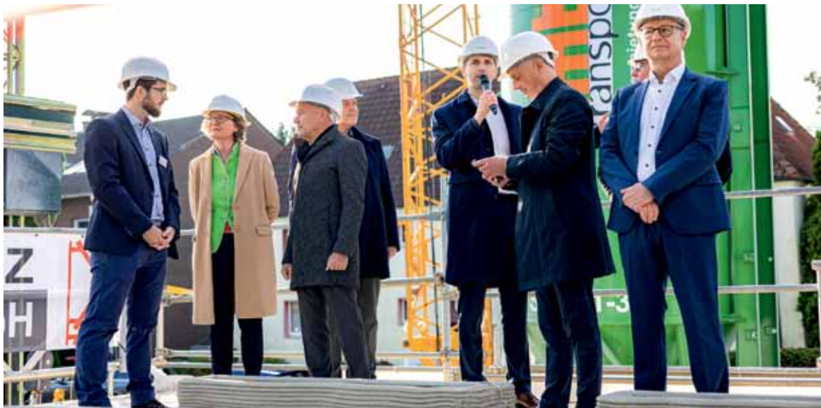
NRW-Bauministerin Ina Scharrenbach lässt sich auf der Baustelle der WBG Lünen den 3D-Druck mit Beton erklären.
