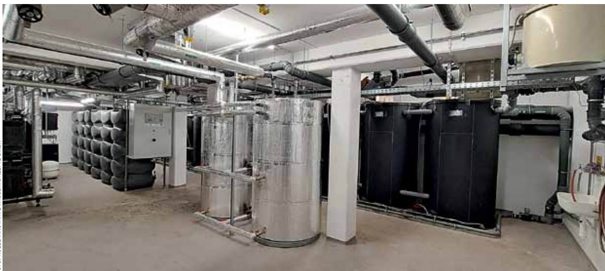
Recyclinganlage für Grauwasser mit Wärmerückgewinnung im Keller des Berlinovo-Studentenwohnheims in der Selma-Lagerlöf-Straße.
