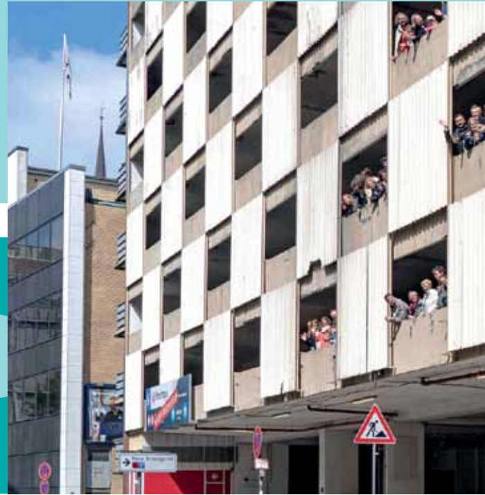
Kaum mehr als eine Ruine: Das Parkhaus in der Hamburger Innenstadt vor dem Umbau.
