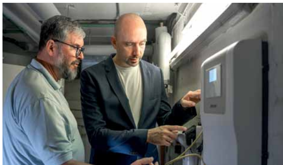
Dirk Prüter (l.), Geschäftsführer von Prüterplan, und Benjamin Gaidel, Handlungsbevollmächtigter bei der Rheinwohnungsbau, lesen gemeinsam die aktuellen Werte der Wärmepumpenanlage aus.
