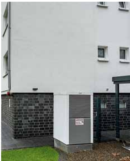
Dezent versteckt: die Außeneinheit der Wärmepumpe auf einem wartungsfreundlichen Aluminium-Montagesockel.
