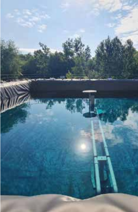
Speichermedium ist normgerechtes Heizwasser, aus Trinkwasser aufbereitet.
