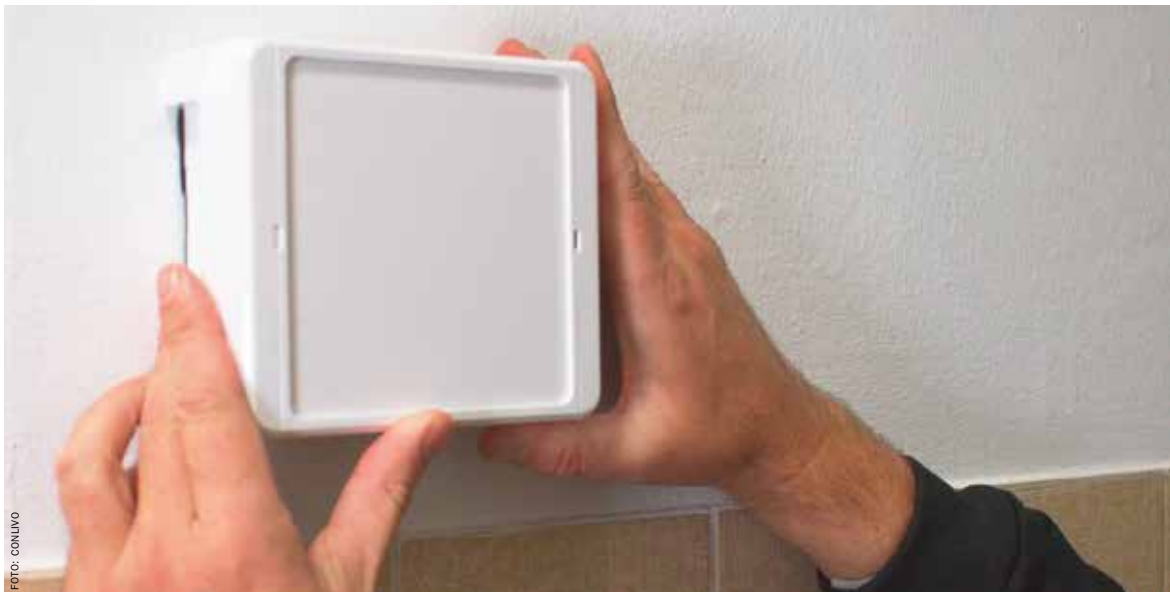
Ein Gateway im Treppenhaus sammelt die Zählerwerte und leitet sie direkt an die Abrechnungssoftware.
