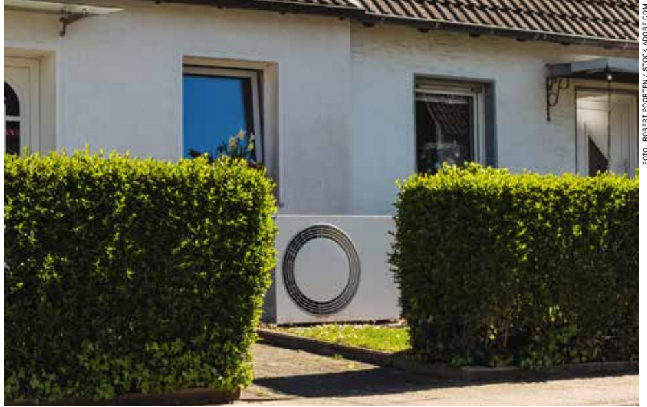
Neue Technologien sichtbar integriert: Eine Wärmepumpe im Vorgarten zeigt die Energietransformation im Wohnungsbestand.
