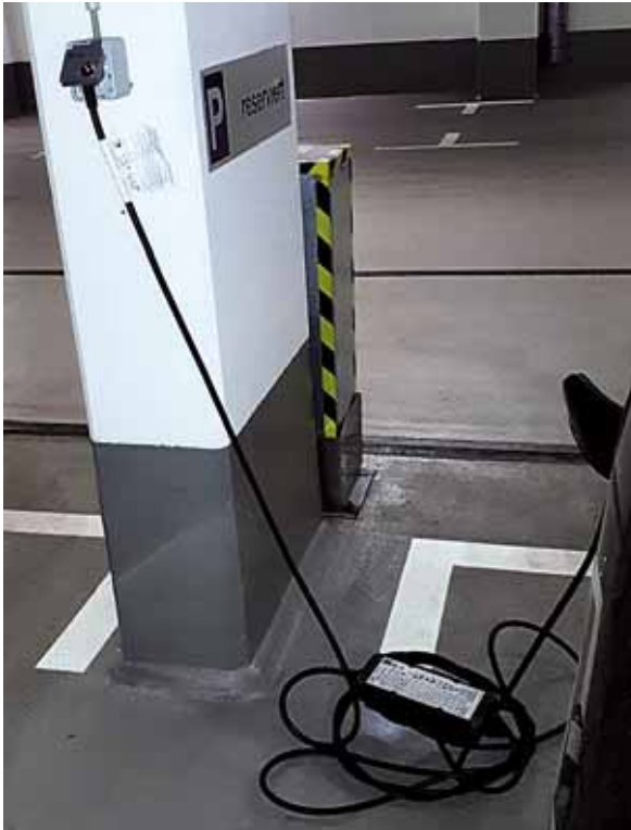
Abbildung 2: Haushaltsübliche Schutzkontaktsteckdose mit eingestecktem Ladegerät – typisches Bild für ein mobiles Ladegerät
