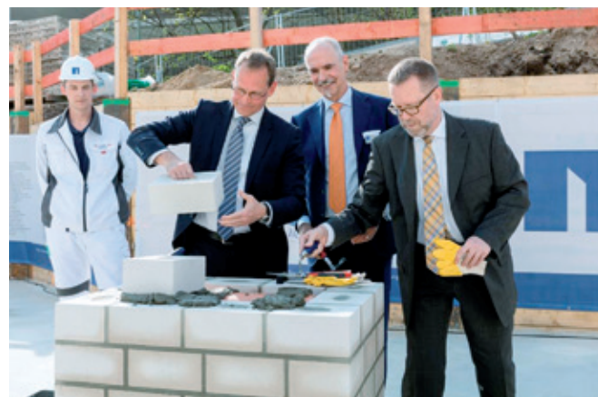
Grundsteinlegung mit Michael Müller (Regierender Bürgermeister von Berlin), Klaus-Dieter Müller (Präsident der Fachgemeinschaft Bau) und Reinhard Naumann (Bezirksbürgermeister Charlottenburg-Wilmersdorf)
